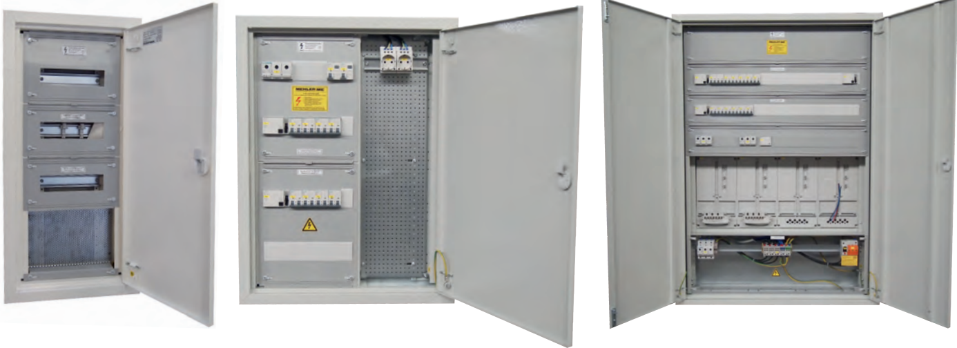
Die Schränke bzw. Schranksysteme wurden von Mehler Elektrotechnik gemeinsam mit den externen Partnern und Prüflabors gemäß der Änderung der Schaltschrankvorschrift EN61439 angepasst.
