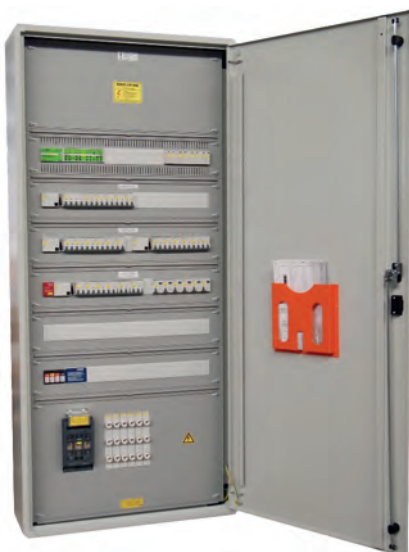
Mehler-Schaltschränke ermöglichen die Aufrechterhaltung des Betriebes ohne Fremdkühlung.
